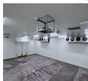
多目的冷蔵保管庫
