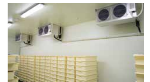
▲貝ひも冷却スペースに設置されたユニットクーラ
